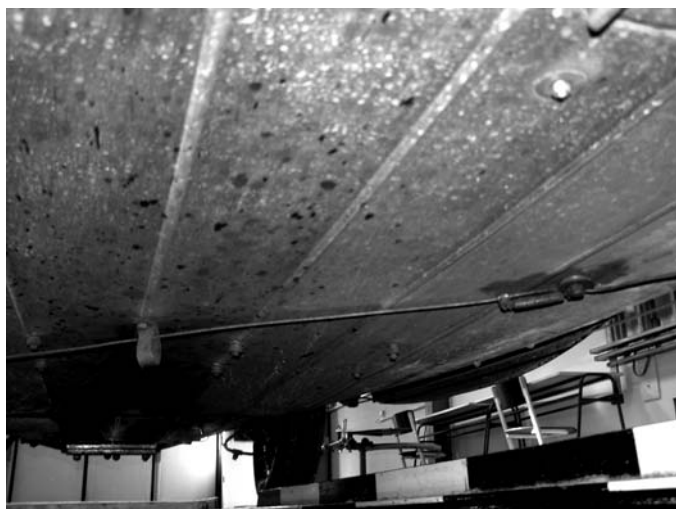
3x foto kontroly podvozku
